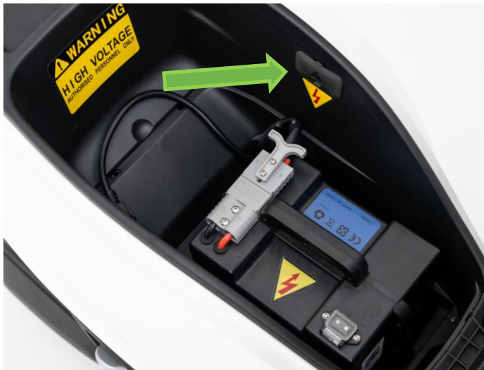
Acceso al interruptor general
